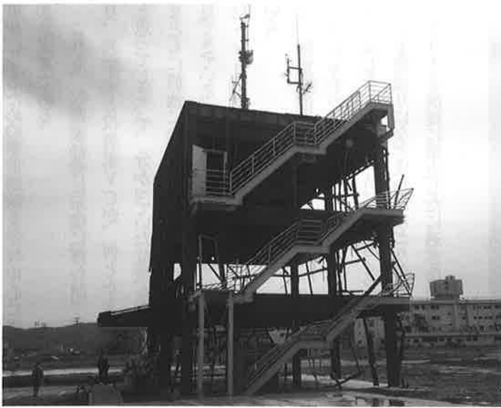
被災した南三陸町の防災対策庁舎（撮影村口）
